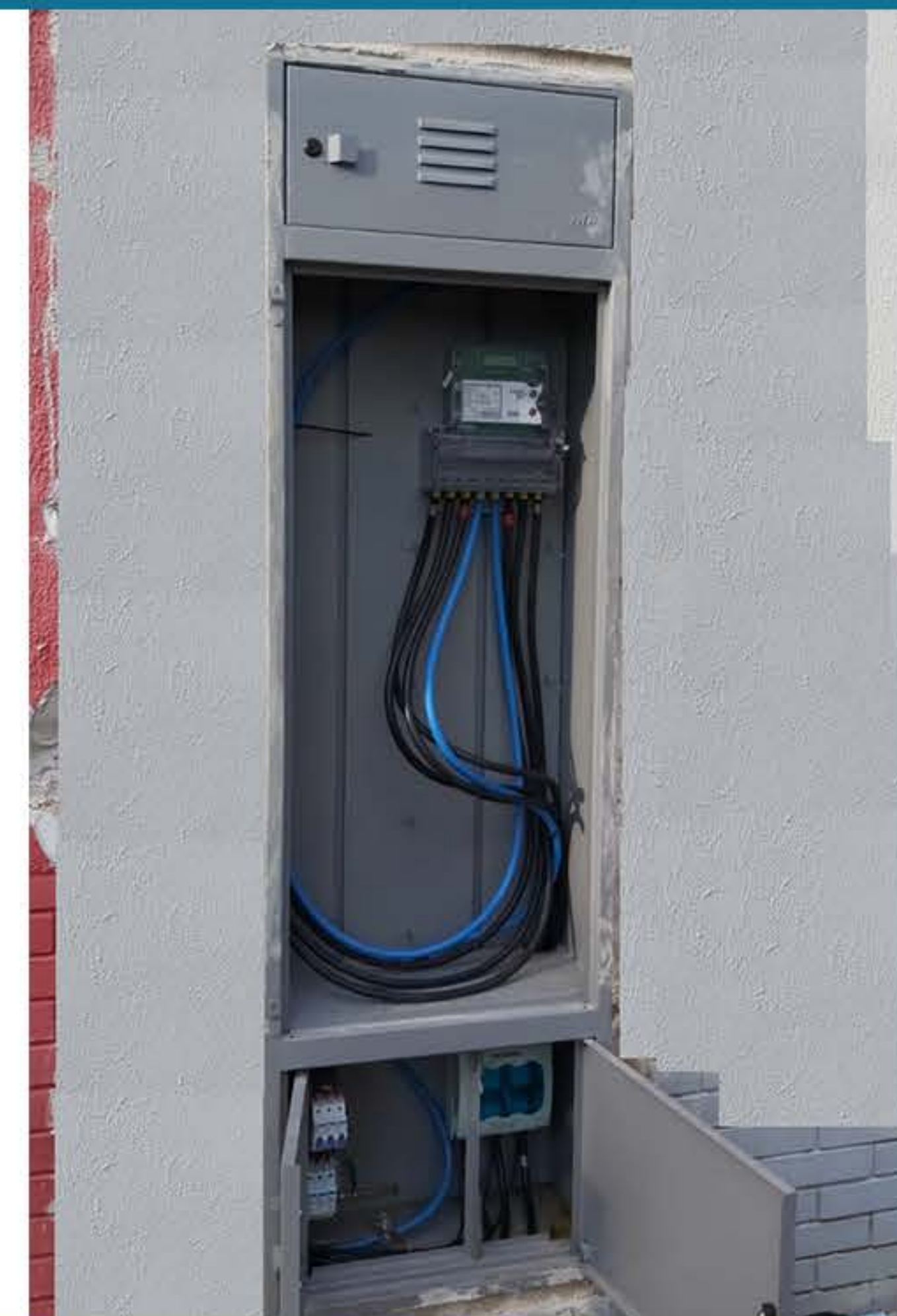
Entrada de Energia em Caixa H Padrão CPFL
